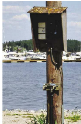
STOLPE: En 3-4 slike stolper med strøm og vann er allerede på plass i strandkanten for å yte bobilturister etterlengtet service ved den kommunalt eide Skjebergkilens Marina.
